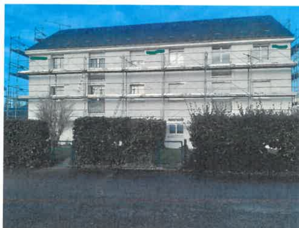
Bâtiment 12 : nids de moineaux
