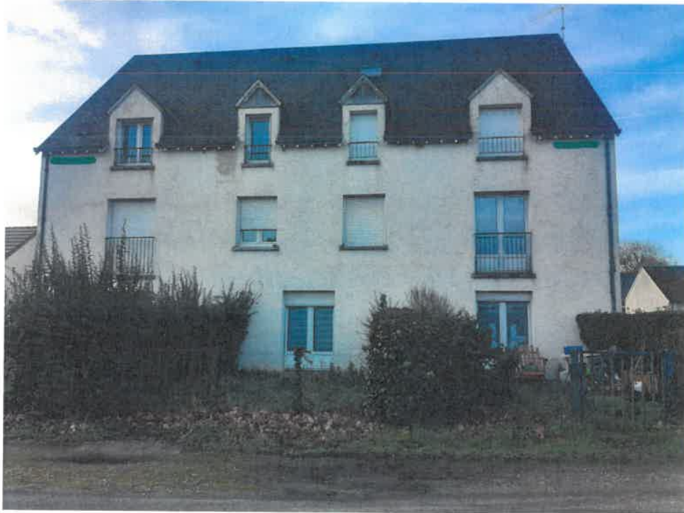
Bâtiment 1 : nids de moineaux
